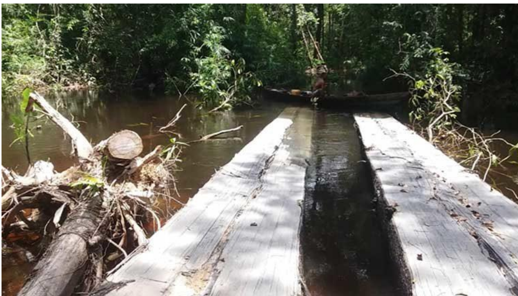
Ponte feita de tronco partido de castanheira, parte do ramal ilegal sendo construído na Reserva Extrativista do Lago do Capanã Grande. Imagem cortesia de cacique que preferiu manter anonimato.
