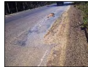
Foto 44 - Detalhe do estado de conservação do pavimento
