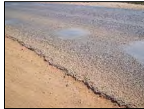
Foto 93 - Detalhe do estado de conservação do pavimento
