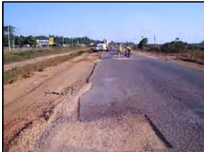
Foto 100 - Detalhe do estado de conservação do pavimento
