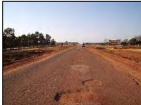
Foto 101 - Detalhe do estado de conservação do pavimento
