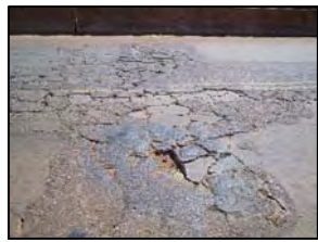
Foto 81 - Detalhe do estado de conservação do pavimento
