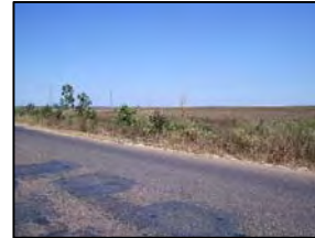
Foto 59 - Estado de conservação e vegetação
