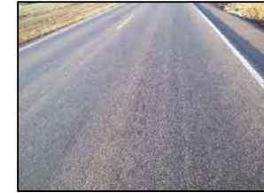
Foto 36 - Detalhe do estado de conservação do pavimento
