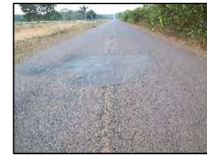
Foto 123 - Detalhe do estado de conservação do pavimento
