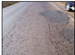
Foto 17 - Detalhe do estado de conservação do pavimento
