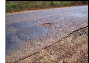
Foto 60 - Detalhe do estado de conservação do pavimento
