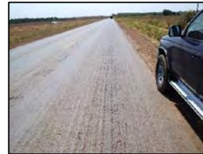
Foto 67 - Detalhe de falha de bico
