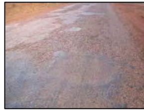
Foto 125 - Detalhe do estado de conservação do pavimento
