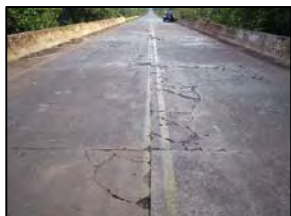
Foto 132 - Detalhe do estado de conservação do pavimento
