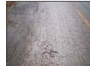
Foto 56 - Detalhe do estado de conservação do pavimento
