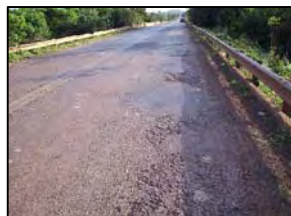
Foto 133 - Detalhe do estado de conservação do pavimento
