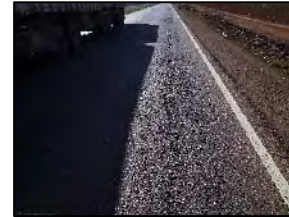
Foto 19 - Detalhe do estado de conservação do pavimento
