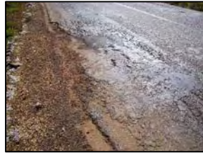
Foto 50 - Detalhe do estado de conservação do pavimento
