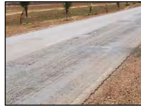
Foto 70 - Detalhe de falha de bico
