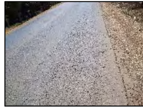
Foto 65 - Detalhe do estado de conservação do pavimento
