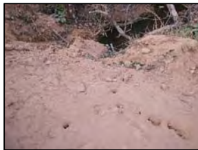
Foto 314 - Detalhe de bueiro metálico assoreado
