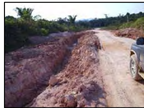
Foto 390 - Vista geral (atoleiro)
