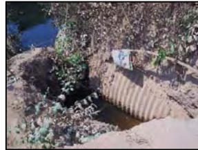
Foto 279 - Detalhe de buelro metálico com problemas ocasionados por falta de boca e drenagem superficial
