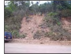
Foto 320 - Escorregamento de talude
