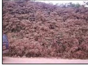
Foto 322 - vegetação de cobertura de taludes de corte (ausência de dispositivo de drenagem profunda)
