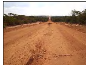
Foto 213 - Vista geral (erosão no meio da pista)
