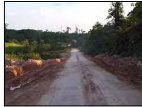
Foto 395 - Vista geral (atoleiro)
