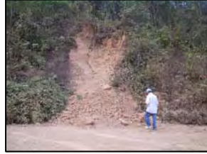
Foto 323 - Detalhe de escorregamento em corte (Talus)
