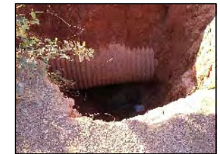
Foto 393 - Detalhe de erosão em OAC metálica
