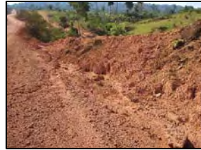
Foto 347 - Detalhe de erosão
