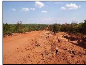
Foto 221 - Erosões provocadas pela ausência de dispositivo de drenagem
