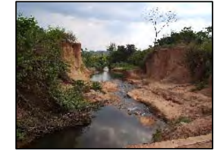
Foto 539 - Erosão no corpo de aterro da rodovia
