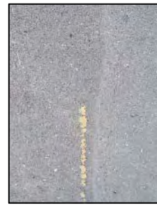
Foto 585 - Detalhe do estado de conservação do pavimento
