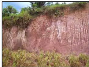
Foto 464 - Detalhe de corte com problemas de estabilidade
