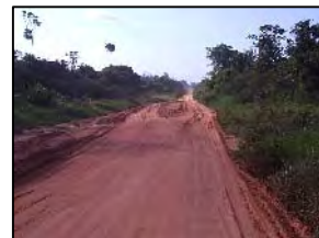
Foto 559 - Vista geral (atoleiro)
