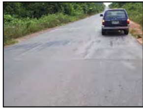
Foto 586 - Recalque em buéiro
