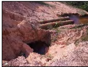
Foto 554 - Erosão em buelro metálico
