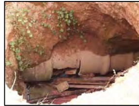
Foto 484 - Erosão provocada por quebra de tubo de concreto
