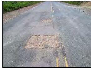
Foto 602 - Detalhe de remendos em concreto de cimento Portland
