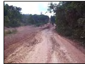
Foto 555 - Vista geral (atoleiro)
