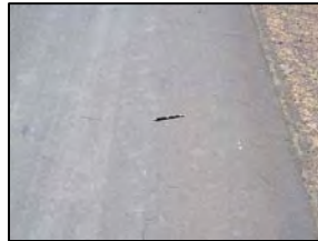
Foto 591 - Detalhe do trincamento
