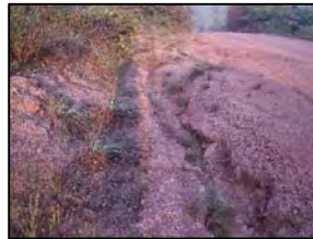
Foto 501 - Detalhe da erosão superficial
