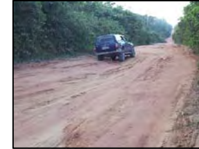
Foto 569 - Vista geral (atoleiro)
