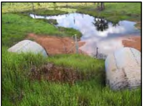
Foto 443 - Bueiro duplo metálico com erosão no talude do aterro
