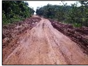
Foto 516 - Vista geral (atoleiro)
