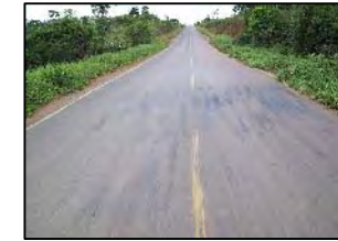
Foto 471 - Detalhe do estado de conservação da superfície (notar recalque na linha do buelro)
